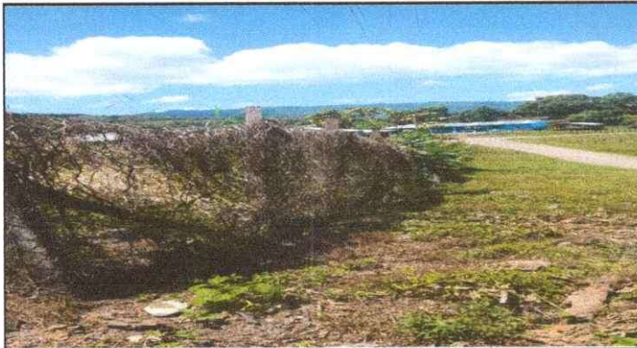
Foto 3: Se observa el daño de las mallas
