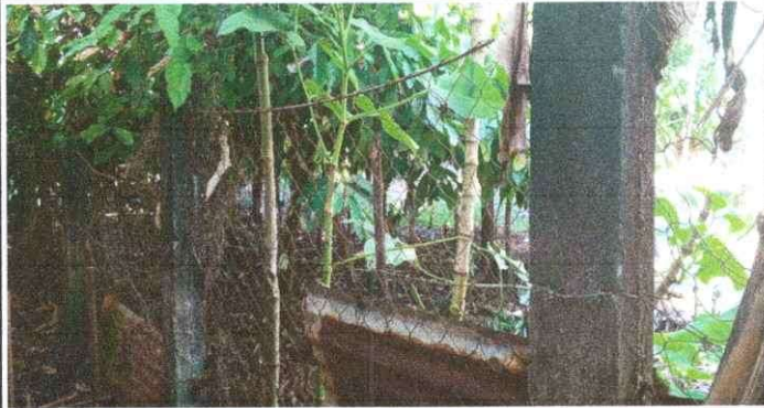
Foto 1: Se observa el muro dañado
